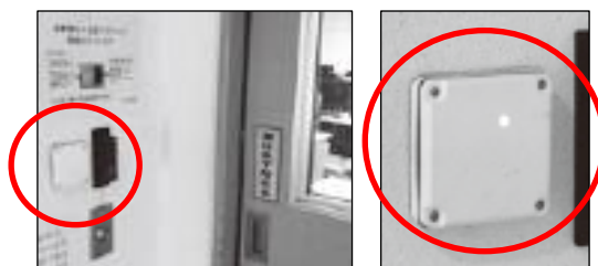
PC 教室外入口の左側に設置
