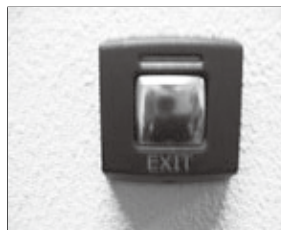
退室ボタン(5号館・2号館)
